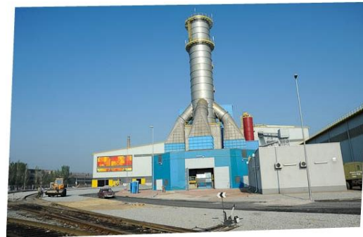
Сучасна система газовидалення та газоочищення
