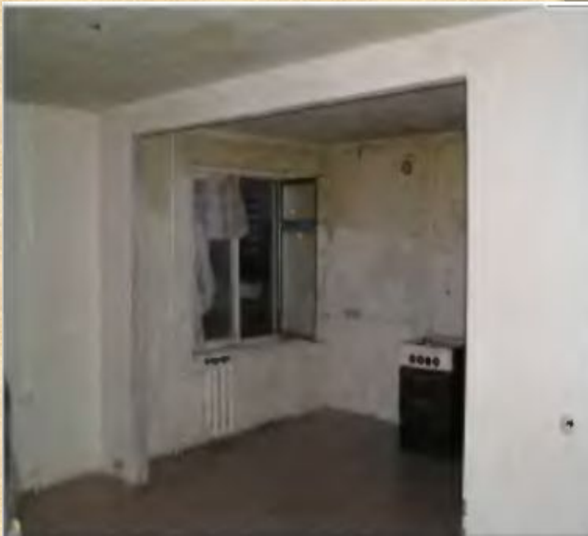
Рис. 5. 2. Самовольная перепланировка квартиры на 3 этаже 9-тиэтажного жилого дома в г. Донецке
