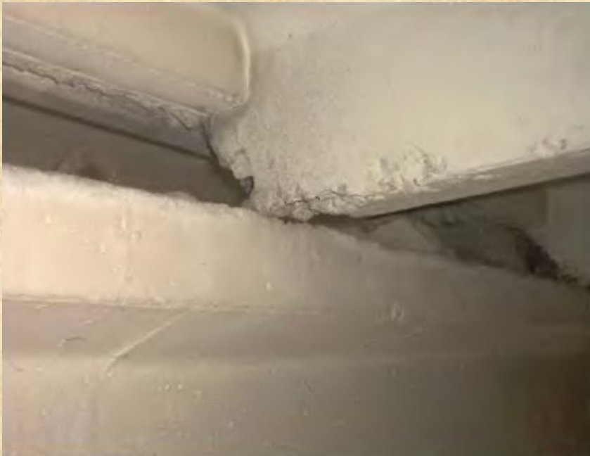
Рис. 6.1. Разрушение опорной части ребристой плиты перекрытия над подвалом
